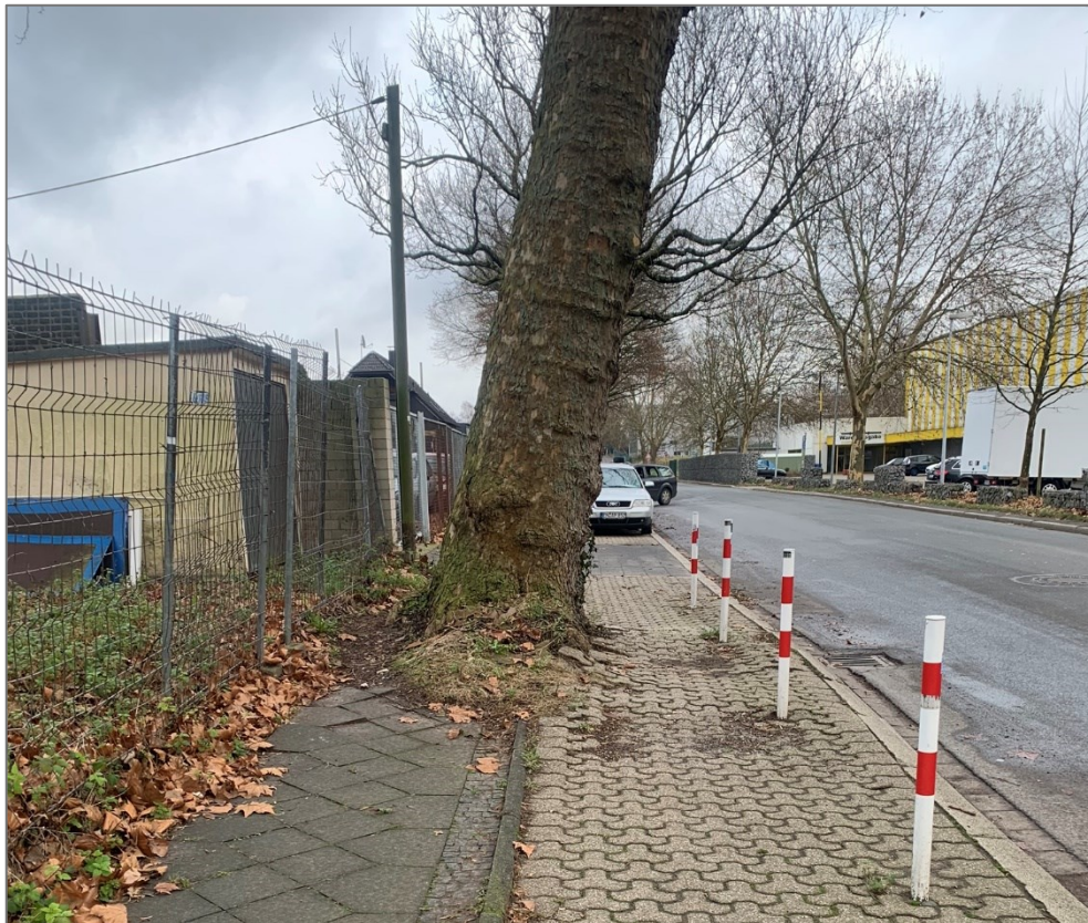
Bild 20: Baumwurzel auf dem Gehweg auf der Frenkingstraße (Foto: IGS mbH)
